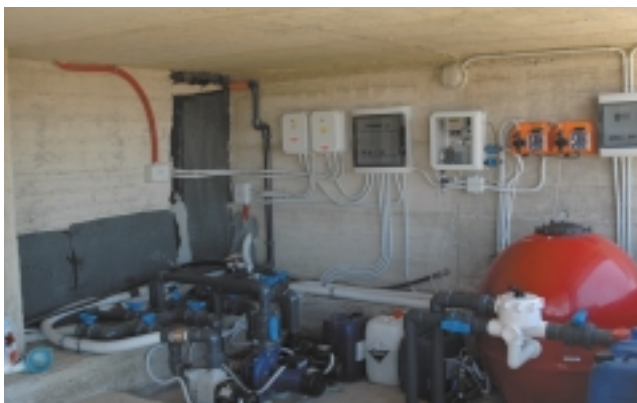
Vista Centrale di trattamento
